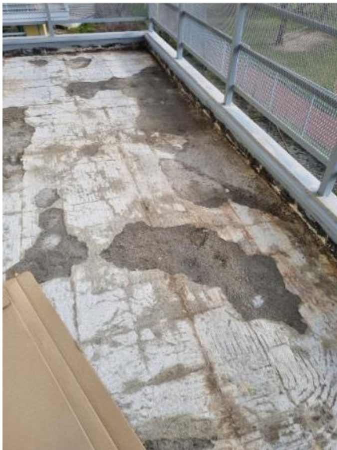
Poškozená podlahová skladba balkonu (Zdroj: Bralep)
